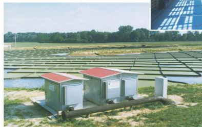
Biologiczna oczyszczalnia ścieków w Klęce.
