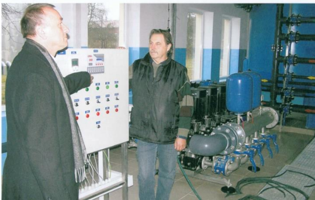
2010 - hydrofornia w Nowym Mieście po modernizacji
