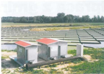
1997 - oczyszczalnia typu Lemna w Kłęce
